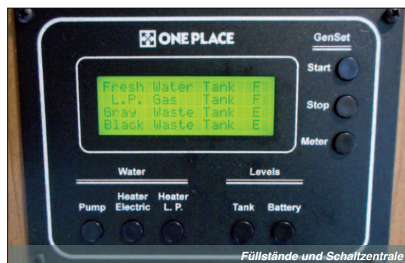
Füllstände und Schaltzentrale
