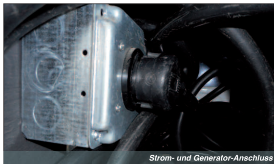
Strom- und Generator-Anschluss
